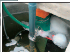
Подача воды в систему Coolbox с помощью погружного насоса
